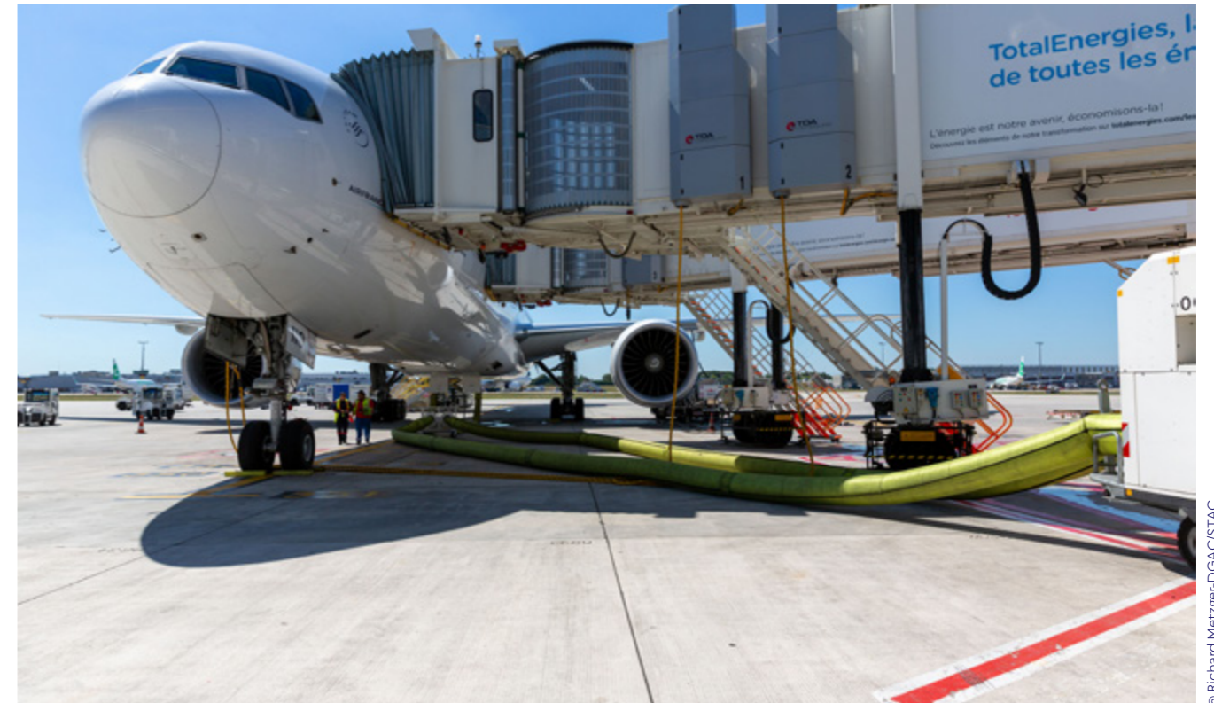
Fourniture d'air conditionné (ACU) et prise 400Hz
