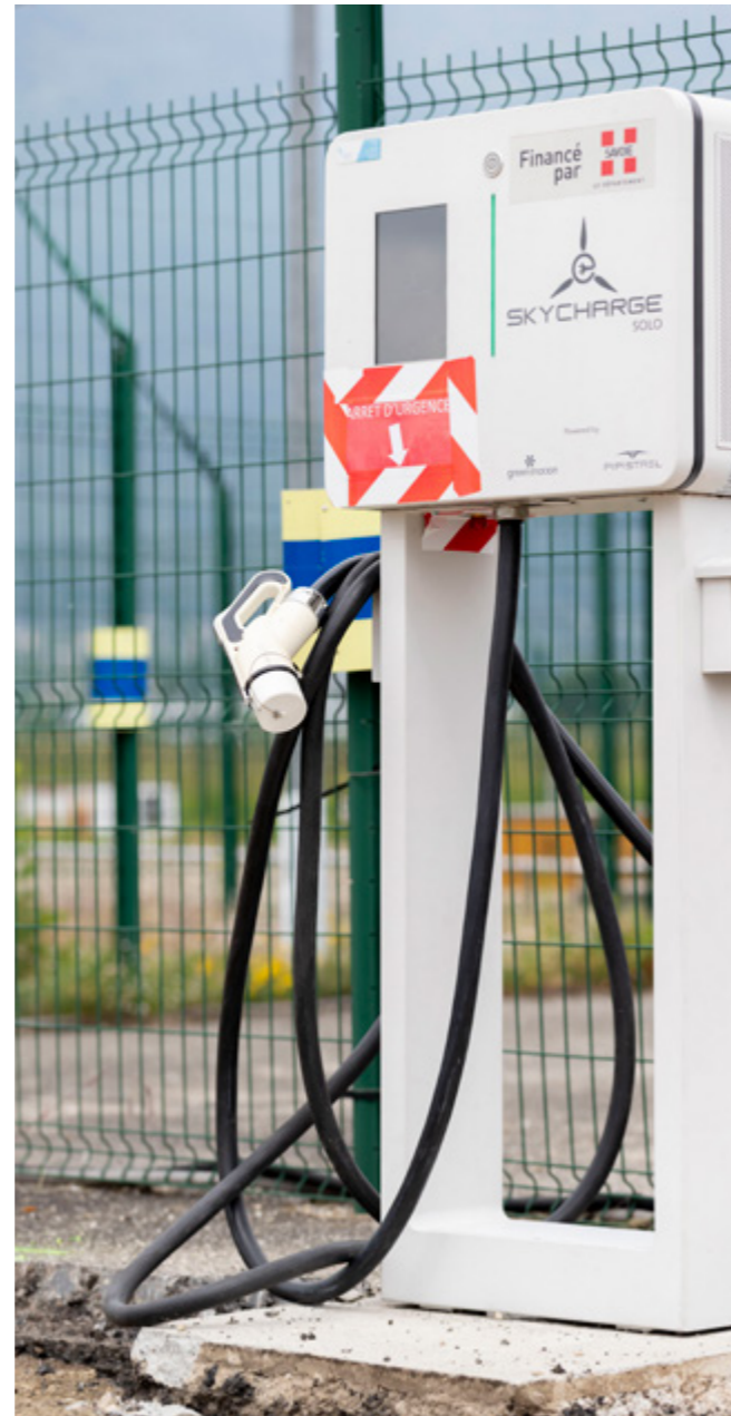
Station de recharge électrique fixe à Chambéry.
